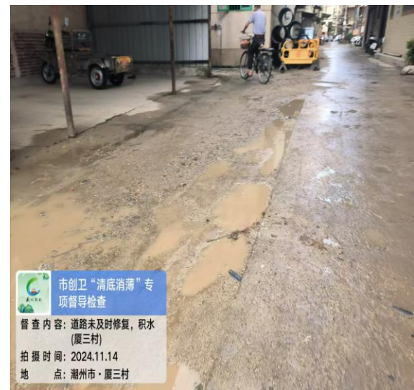
市创卫“清底消薄”专项督导检查 督查内容：雨污分流工程施工无围挡（北关村） 拍摄时间：2024.11.14 地点：潮州市湘桥区·宫前街北大巷
